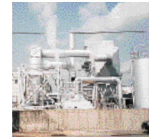
24時間800 を超える高温連続運転の大型焼却炉(サーマルリサイクル)
