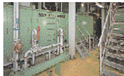
コージェネレーションシステム
