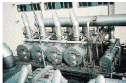
溶剤回収・リサイクル設備
