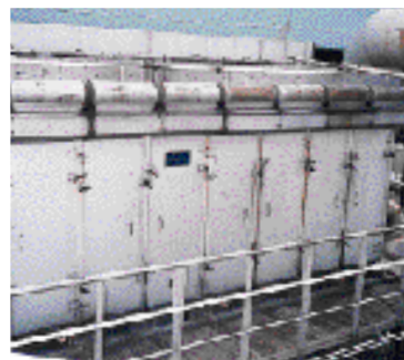
ばい煙除外設備 (シンターラメラフィルター)
