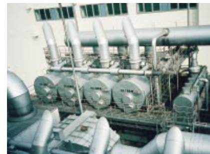
溶剤回収・リサイクル設備
