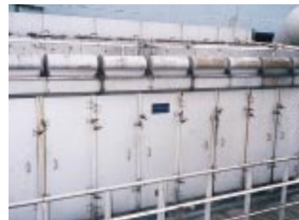
ばい煙除外設備 (シンターメラフィルター)
