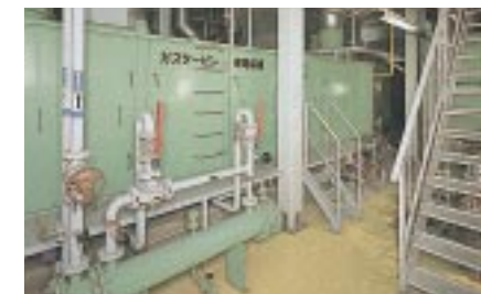
コージェネレーションシステム
