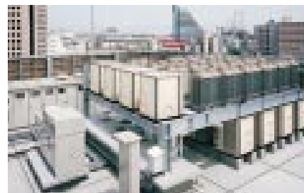
氷蓄熱式ヒートポンプ
