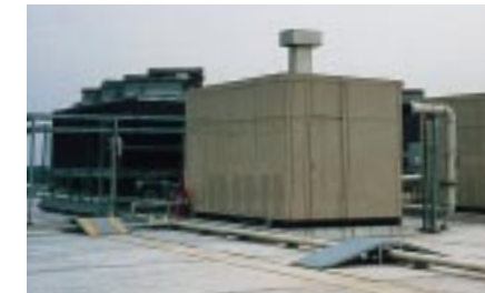
吸収式冷凍機
