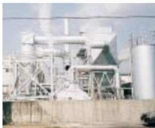
24時間800 を超える高温連続運転の大型焼却炉（サーマルリサイクル）
