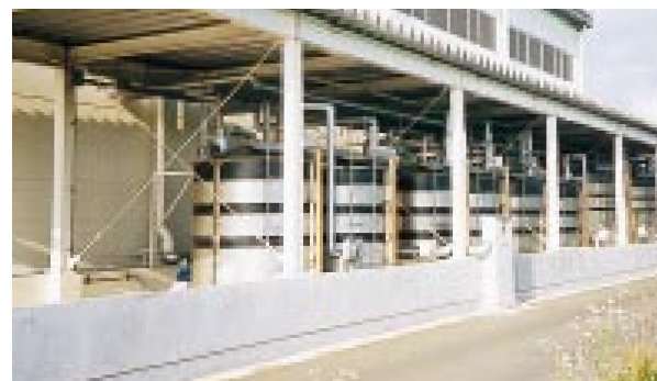
廃液タンク防液堤
