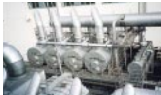
溶剤回収リサイクル設備
