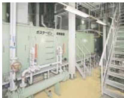
コージェネレーションシステム
