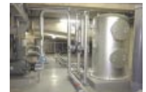
中水リサイクル装置 (小石川ビル)
