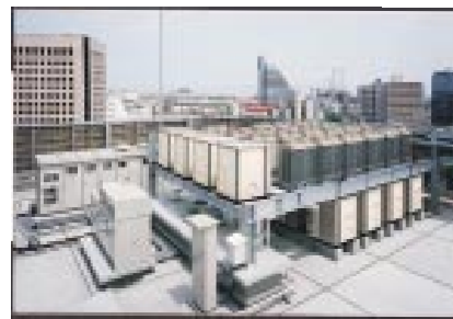
氷蓄熱式ヒートポンプ (芝浦ビル)
