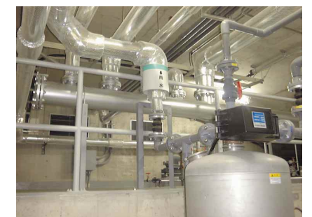
雨水配管（トッパン小石川ビル）
