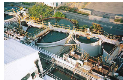
排水処理施設 / 凝集沈殿槽
