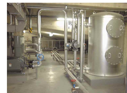
中水リサイクル（トッパン小石川ビル）
