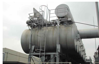
溶剤回収リサイクル設備
