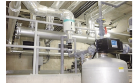
雨水配管(トッパン小石川ビル)
