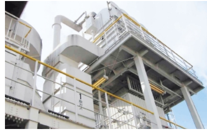
溶剤回収リサイクル設備
