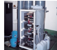
油水分離装置
