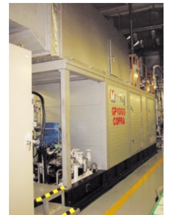
福岡第一工場のコージェネレーション
