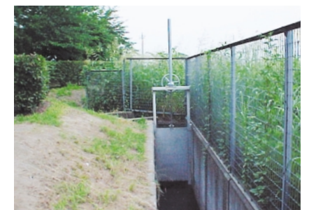
公共用水域流入口への水門の設置
