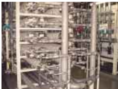
排水リサイクル設備／三重工場
