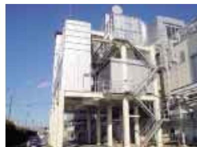
群馬工場に導入した排ガス処理設備
