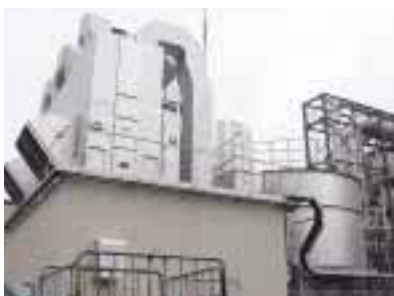
排ガス燃焼処理設備／仙台工場
