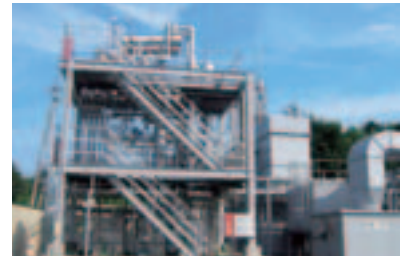
排ガスを溶剤回収処理装置で回収～精製することにより、排ガス中のVOCを再生溶剤として事業所内で循環利用(松阪工場)
