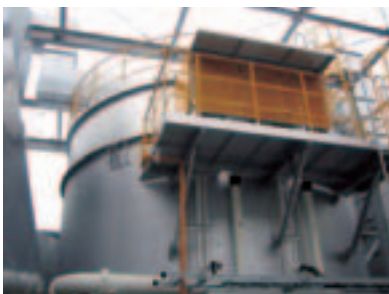
排ガス処理設備(福岡工場)
