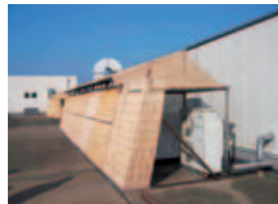
直射日光遮蔽による空調室外機効率低下防止対策(日除け設置)
