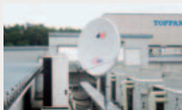
緊急地震速報を受信するパラボラアンテナ
