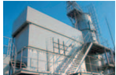
VOC排ガスからの溶剤回収装置 (群馬工場)
