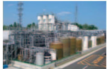
排水処理リサイクルシステム (三重第二工場)
