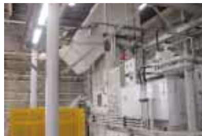
屑処理装置(トッパンコンテナ(株)宮城工場)
