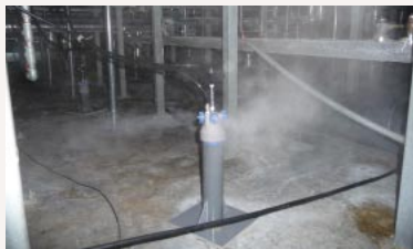
噴霧器の活用による空調湿度調整 (富山工場)
