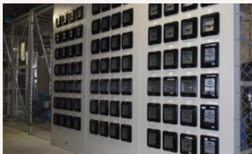
電力量計によるエネルギー計測(神辺凸版)
