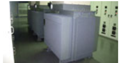
高効率変電設備 (株)トッパンエレクトロニクスプロダクツ 堺工場
