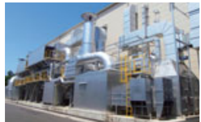
排ガス処理装置 (深谷工場)
