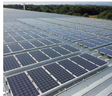
太陽電池パネル(深谷工場)
