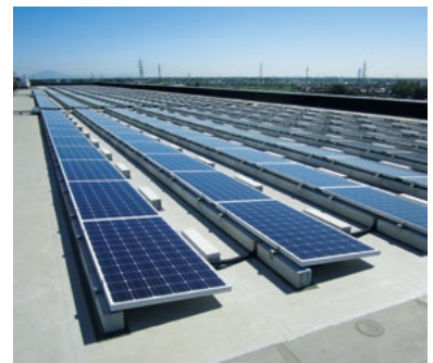
太陽電池パネル(総合研究所実験センター)
