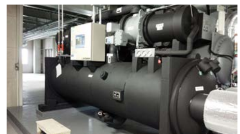
高効率な冷凍機(坂戸工場)
