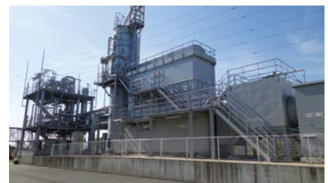
溶剤回収装置(群馬センター工場)
